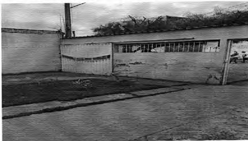
FOTO 2: Entrada principal obs.: parede com infiltrações, em decorrência da umidade do solo.
