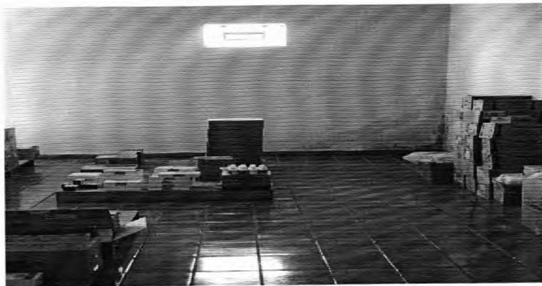
FOTO 3: Espaço para armazenamento de materiais hospitalares. Obs.: parede com infiltração
