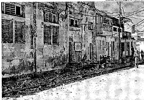
Casas em Santiago foram danificadas pelos terremotos que atingiram a ilha
