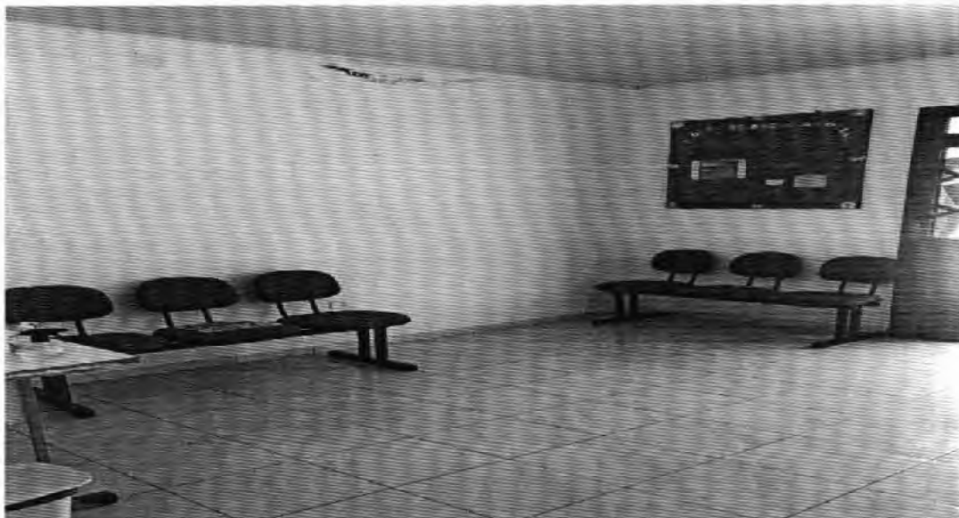
FOTO 6: Sala de trabalho obs.: (infiltração na parede em decorrência vazamento de água pelo o forro de pvc).
